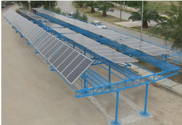
شکل ۲: نمایی از نیروگاه خورشیدی 20kW دانشگاه شهید چمران اهواز
